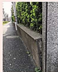
斜めに傾いている喜沢中学校のブロック塀
